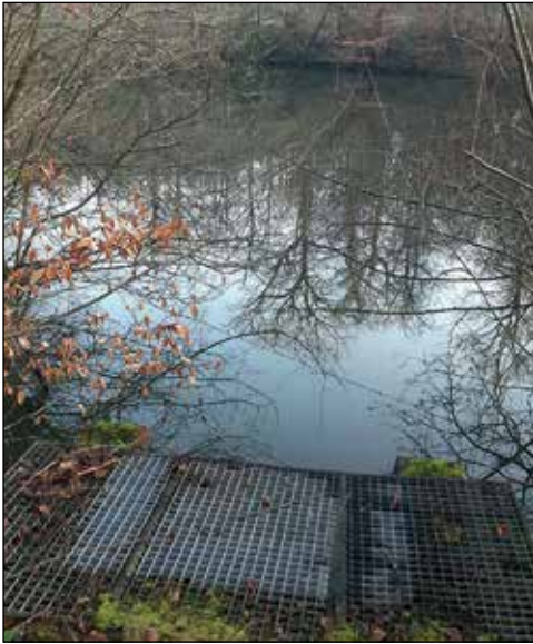
Der Mönch sorgt als Auslaufbauwerk für einen geregelten Wasserabfluss (Jan. 2022).
